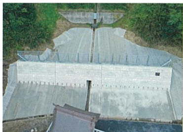
▲治山施設（落石防護工）
